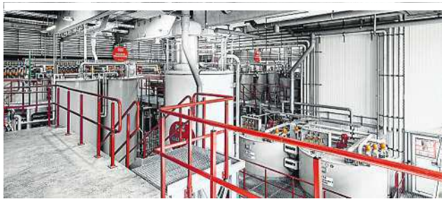
Flüssige Spezialabfälle werden durch chemische, physikalische und biologische Prozesse behandelt und zu über 85 % in den natürlichen Wasserkreislauf zurückgeführt
